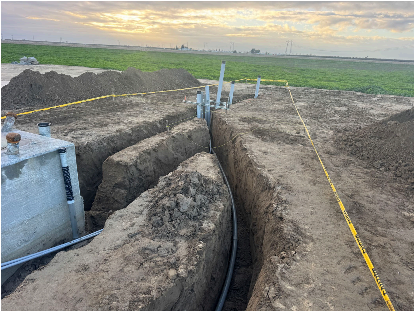
Electrical Conduit Installation
